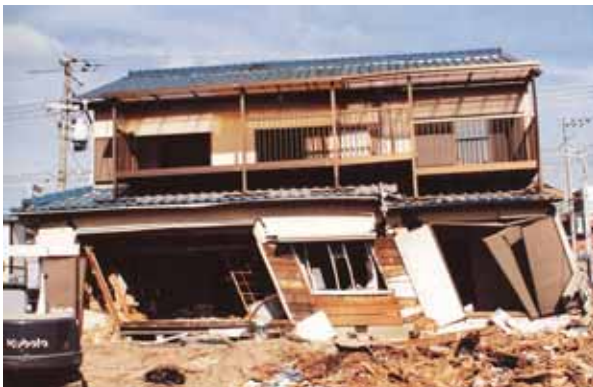
1階部分に壁が少なく耐震性が劣る住宅 (南面部が大きく壁が少ない)
